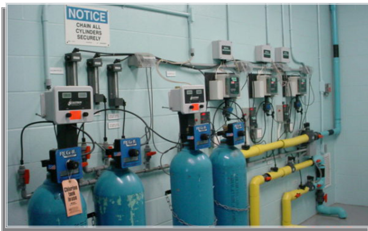
▲ کپسولهای گاز کلر و تاسیسات مربوطه در موتورخانه استخر هتل با وجود همه نکات ایمنی هیچ اثری از ماسک و وسایل تنفسی اورژانس نیست
