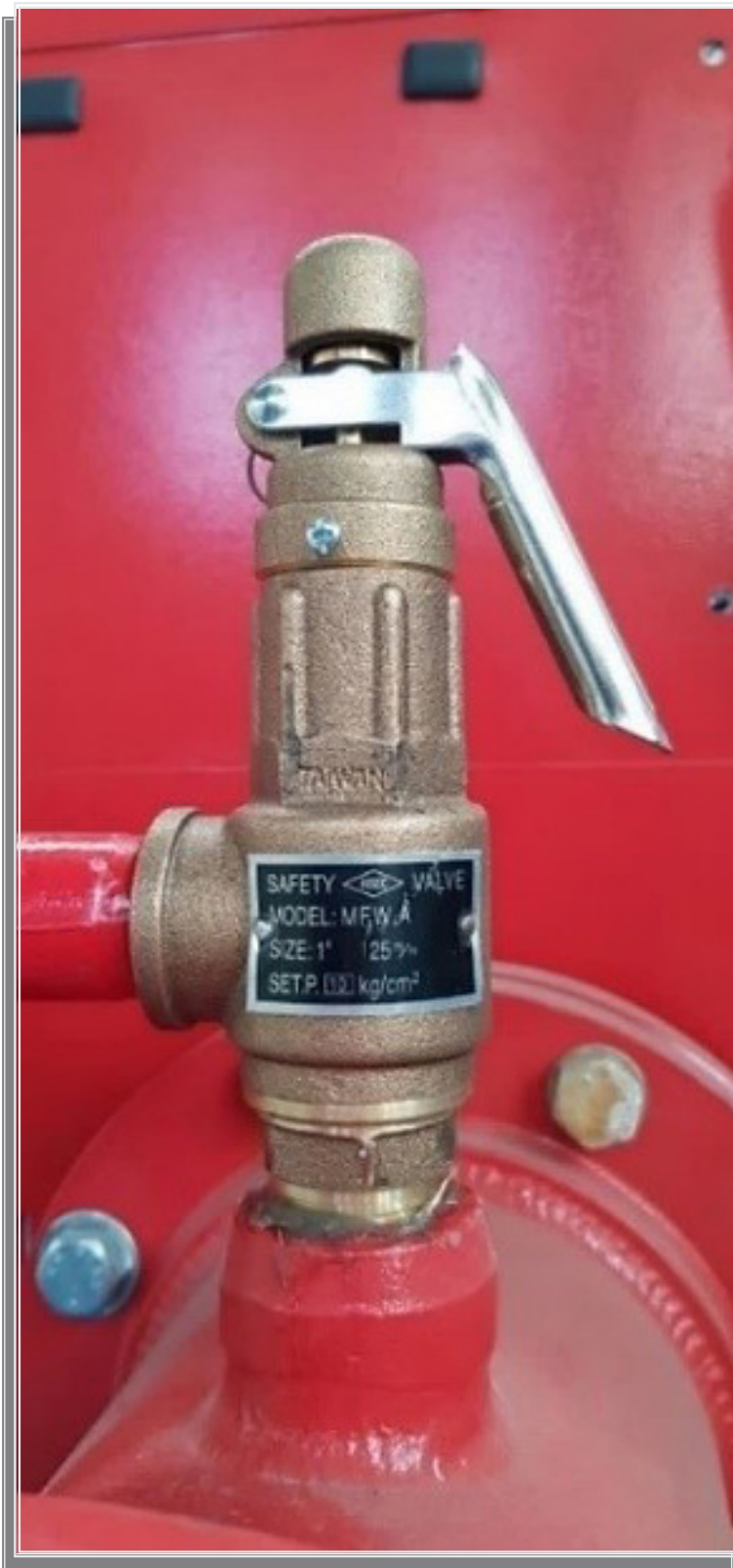
▲ شیر اطمینان نصب شده در مسیر آب ورودی
