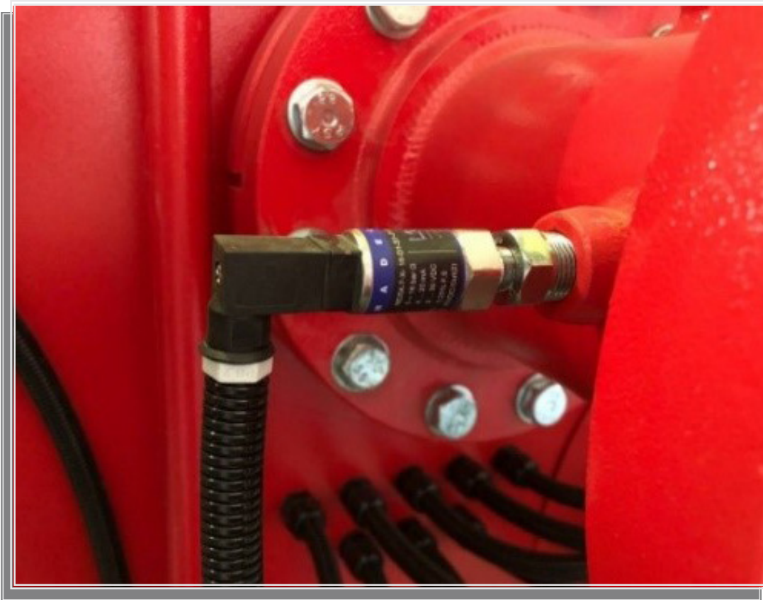
▲ ترنسمیتر فشار نصب شده در مسیر آب خروجی
